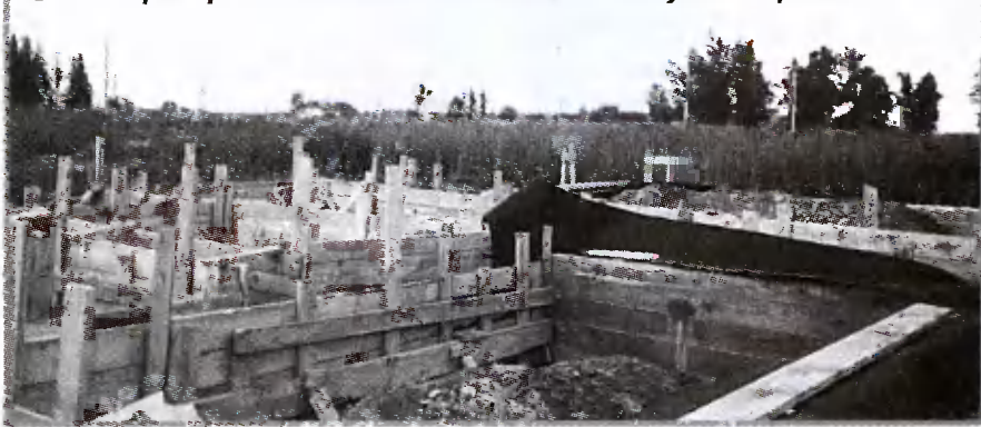
Пример некачественного выполнения опалубочных работ
